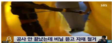
공사 완료 전 비닐보양지 훼손
