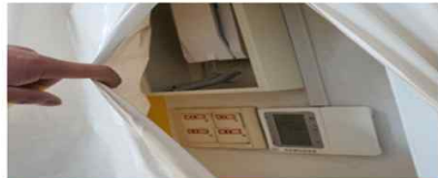
전기(에어컨 전원 ON 상태) 안전조치 불량
